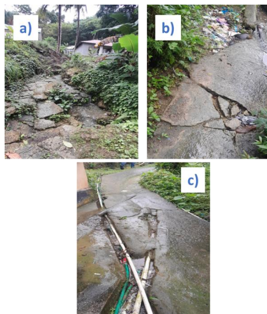
Gambar 1. Pengamatan di lokasi yang menunjukkan indikasi tanah merayap: a, b dan c merupakan retakan-retakan pada area jalanan maupun halaman perumahan penduduk.
